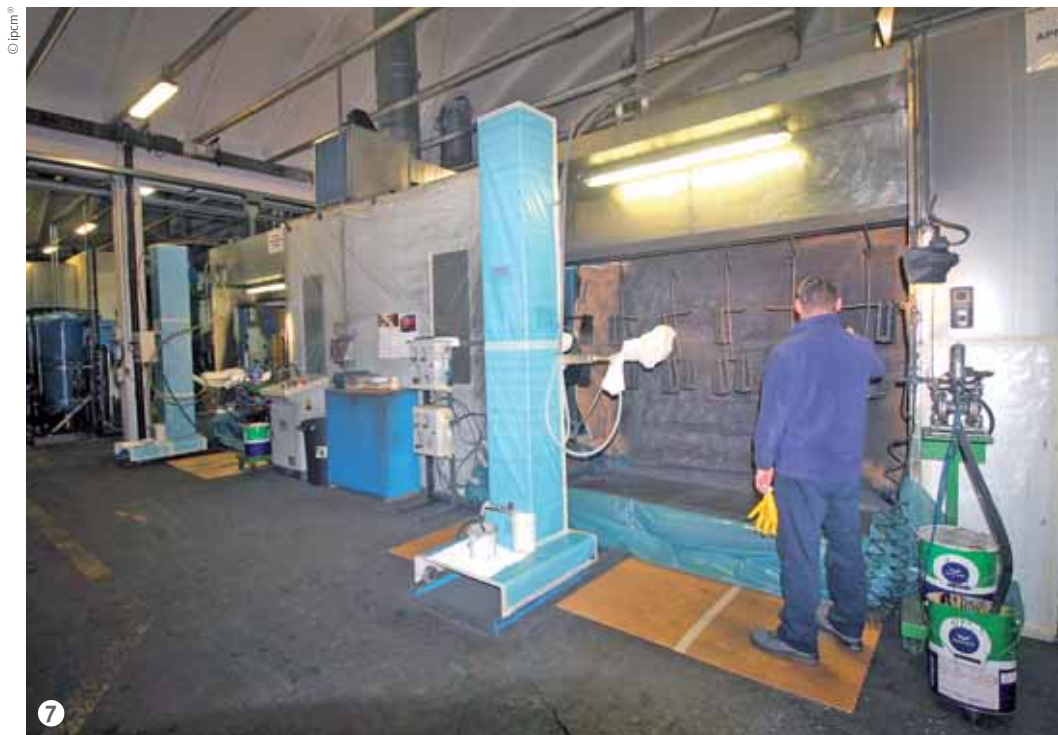
Figura 7: Le due cabine a secco per l'applicazione di primer e smalto.
