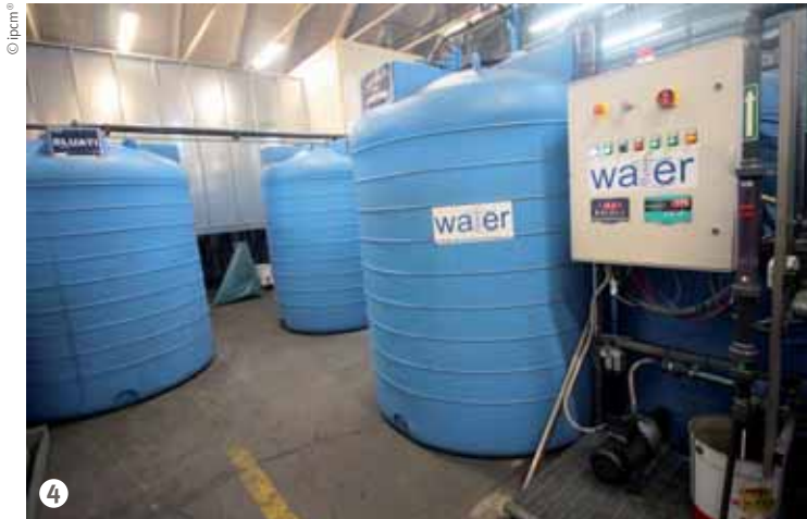
Figura 4: In primo piano le due colonne del sistema di demineralizzazione: una con resina cationica, l'altra con resina anionica.
