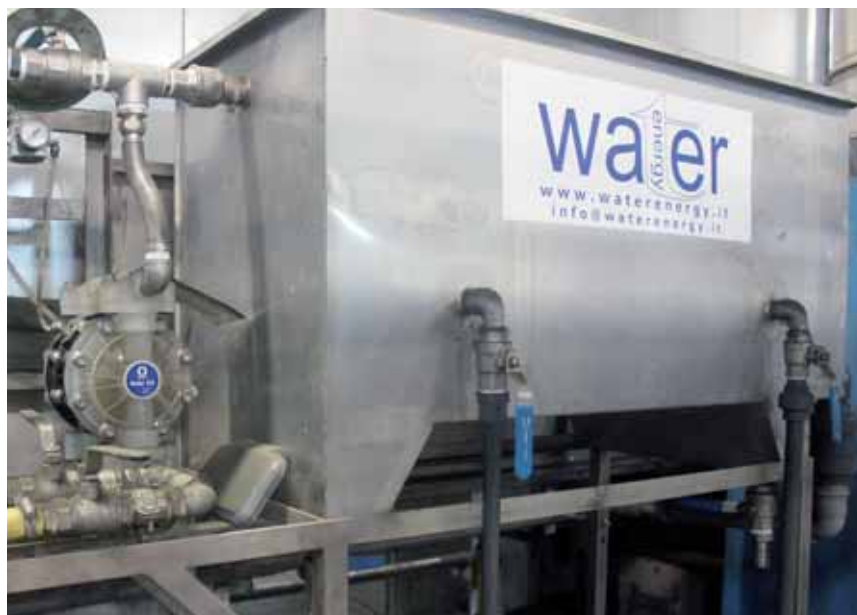
Figura 6: Il disoleatore per la separazione degli oli minerali delle vasche di pretrattamento.
