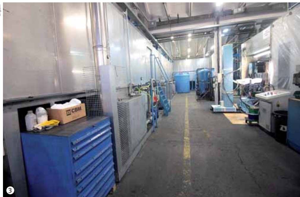
Figura 3: Esterno del tunnel di pretrattamento e, a destra, l'impianto di demineralizzazione delle acque.
